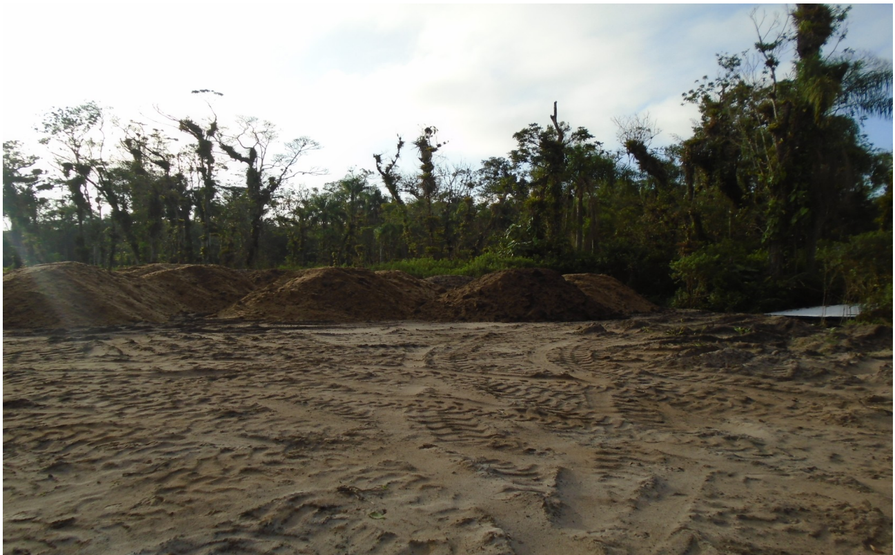
Terraplanagem e deposição de materiais para aterramento sem autorização de órgão ambiental
