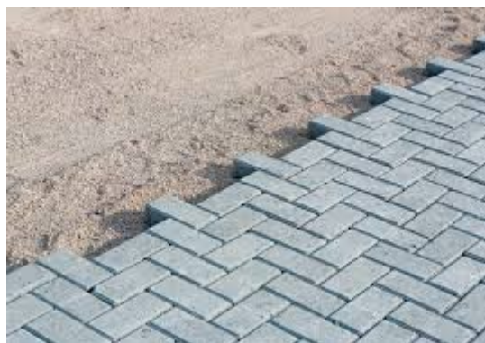
FIGURA 5 - IMAGEM DO BLOCO DE CONCRETO INTERTRAVADO
