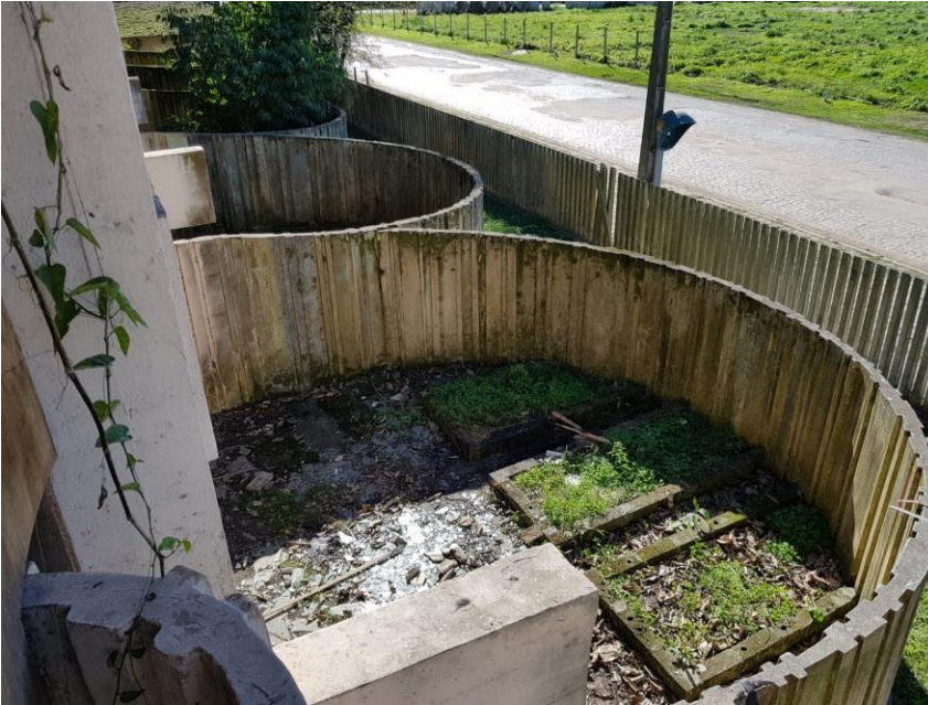
Muro de concreto armado da área externa afetado pela umidade. Solução: lavagem, raspagem e pintura conforme item 7.6.
