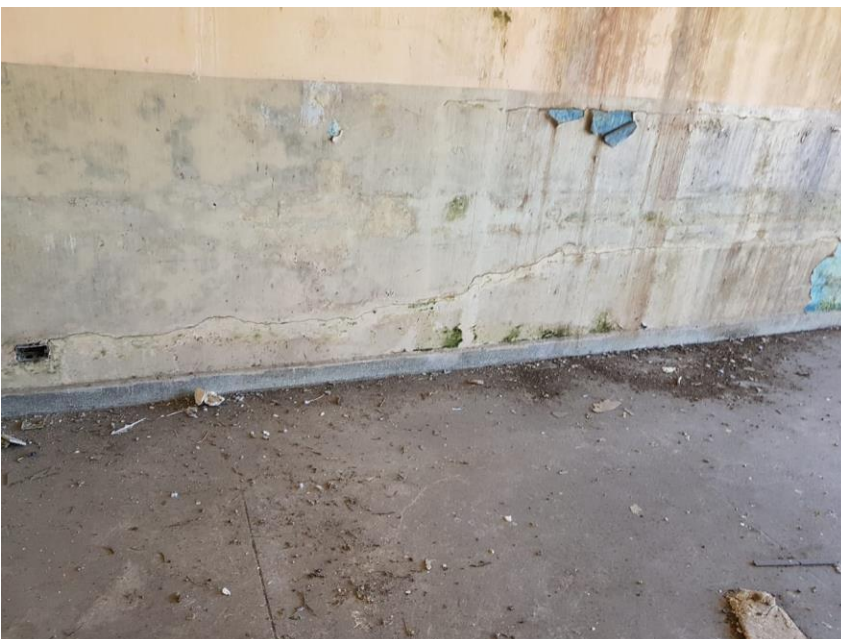
Fraturas inclinadas e horizontais de flexão de viga. Solução: Reforço estrutural conforme item 7.9.
