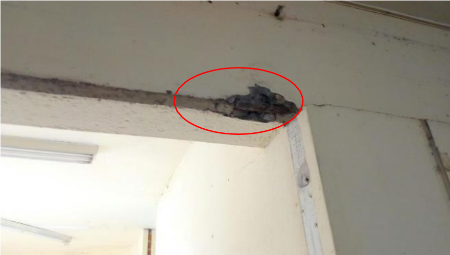
Viga com danos de corrosão. Necessidade de recuperação conforme item 7.3.
