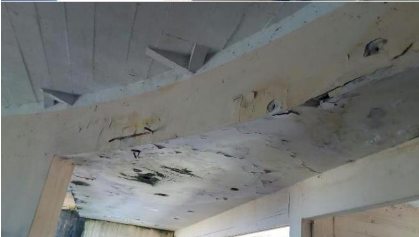
Umidade, bolhas, descolamento da pintura e corrosão na laje da cobertura. Solução execução de itens 7.3, 7.4, 7.6.
