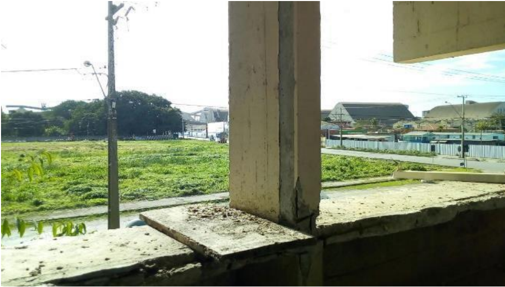
Pilares esbeltos na fachada sendo atacados pela corrosão. Recomposição conforme item 7.3.
