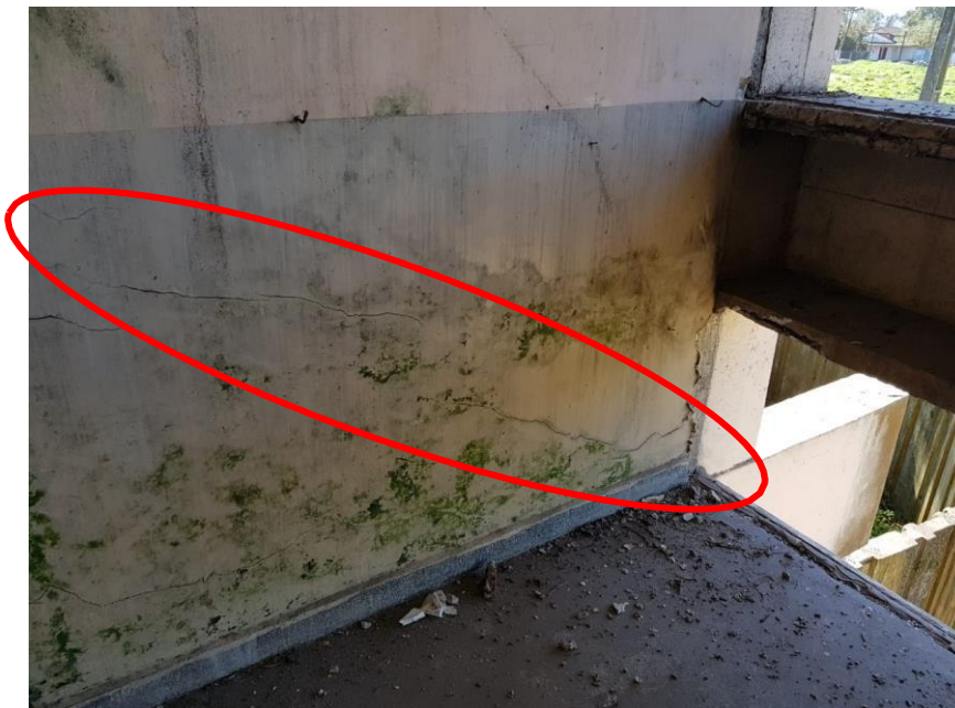
Fraturas típicas de flexão da viga. Promover remoção da camada de granitina conforme item 7.4 e reforço nos pontos de apoio da laje pre moldada conforme item 7.9. Após reforço, proceder com vedação das fissuras conforme item 7.5 e lavagem, raspagem e repintura conforme item 7.6.
