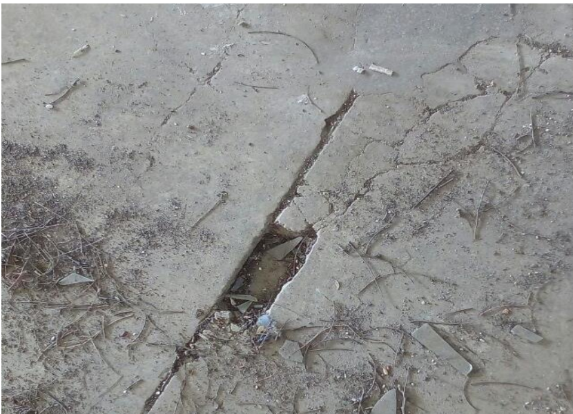
Piso de granitina sobre piso original. Sobrepeso que causou flexão. Remover piso existente conforme item 7.4
