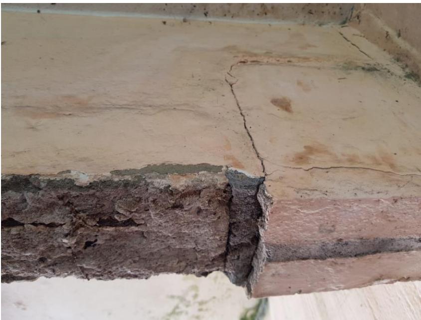
Deslocamento da viga pré moldada e descolamento do revestimento. Solução: Recuperação estrutural conforme item 7.3.
