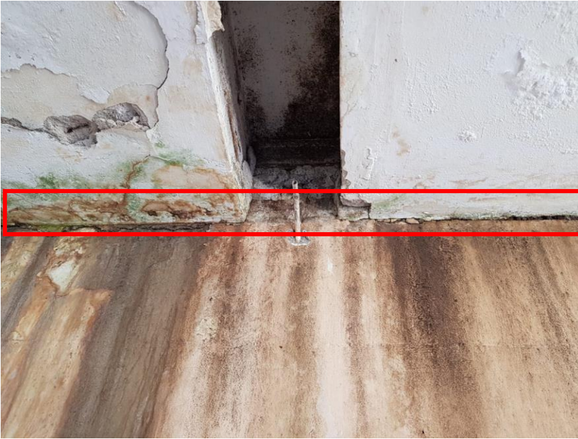
Deslocamento da laje pré moldada. Solução: Reforço estrutural conforme item 7.9.
