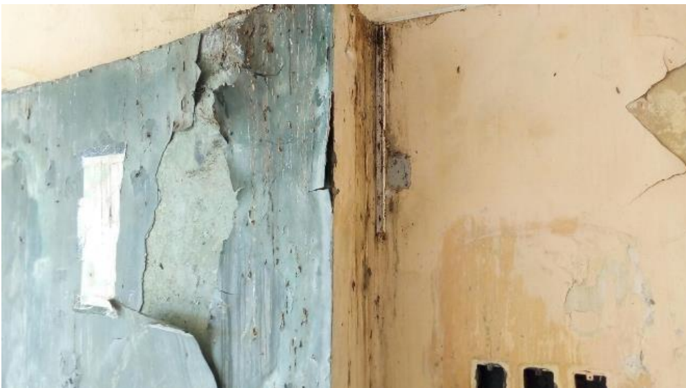
Alvenaria com revestimento comprometido pela umidade. Devera ser promovido a selagem de trincas conforme item 7.5 e lavagem, raspagem e pintura conforme item 7.6.
