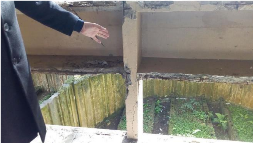
Peças estruturais na fachada com risco de colapso devido corrosão. Retirar vigas de fachada conforme item 7.2 e recuperar pilares conforme item 7.3.
