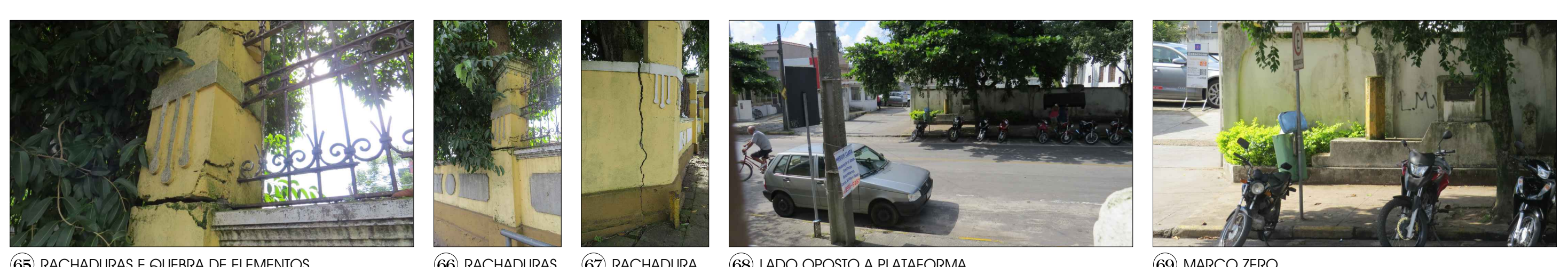
65 RACHADURAS E QUEBRA DE ELEMENTOS. 66 RACHADURAS. 67 RACHADURA. 68 LADO OPOSTO A PLATAFORMA. 69 MARCO ZERO.
