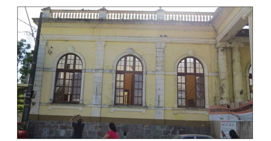
21 LIMO NOS ORNAMENTOS, FALTA DA COBERTURA, ESQUADRIAS DANIFICADAS.
