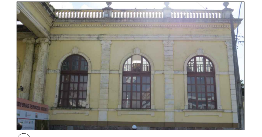
20 LIMO NOS ORNAMENTOS, FALTA DA COBERTURA, ESQUADRIAS DANIFICADAS.
