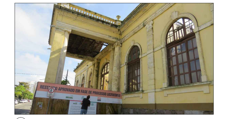
19 LIMO NOS ORNAMENTOS, FALTA DO TELHADO.
