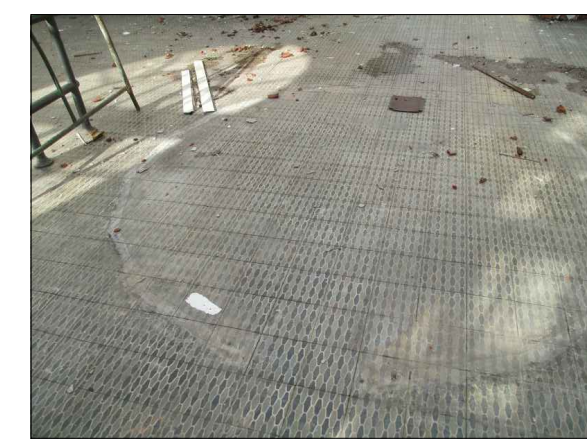
09 PISO HIDRÁULICO DANIFICADO, AUSÊNCIA DO GUICHÊ.
