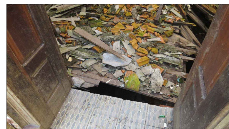
42 PISO PERDIDO E CAIXILHOS COM DEFEITOS.
