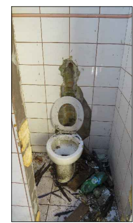
25 FORRO E COBERTURA INEXISTENTES.
