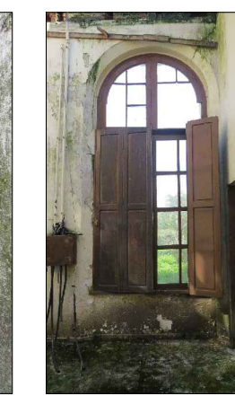
37 ESQUADRIA COM VIDROS E MADEIRA QUEBRADOS.
