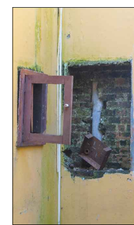
43 MANCHAS E INSTALAÇÕES ELÉTRICAS APARENTES.
