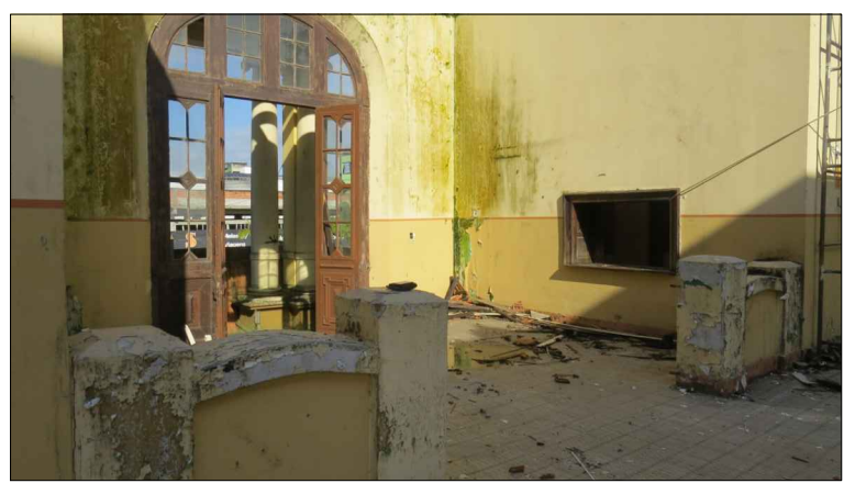
48 MURETAS E PAREDES DESCASCANDO E COM MANCHAS, ESQUADRIA COM VIDROS QUEBRADOS.
