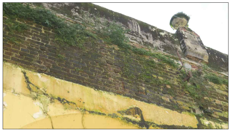
31 FORRO E COBERTURA INEXISTENTES, LIMO NAS PAREDES E NOS ORNAMENTOS DA FACHADA.
