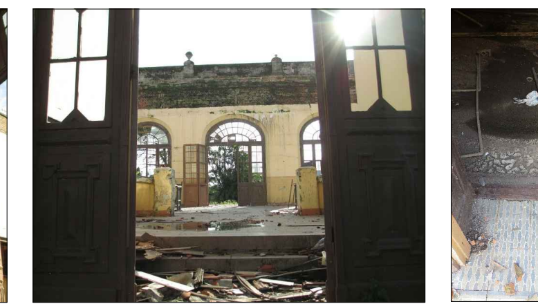
52 MANCHAS DE LIMO NOS ORNAMENTOS DA FACHADA.
