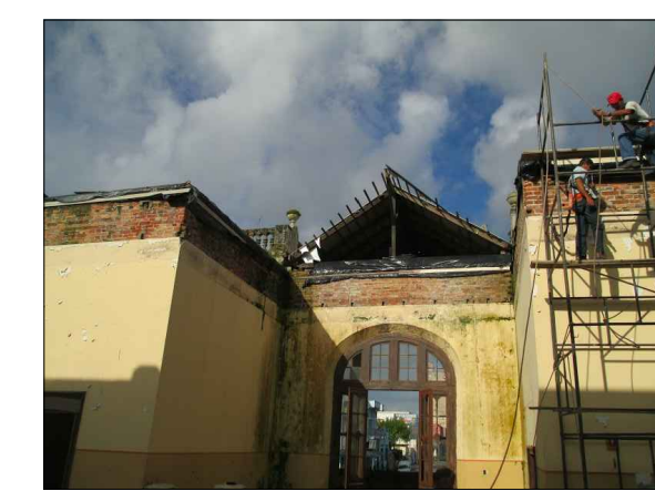
10 AUSÊNCIA DO FORRO E COBERTURA, PINTURA E ALVENARIA DETERIORADAS.
