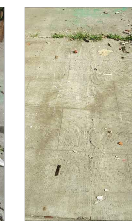
19 RACHADURA NO PISO.
