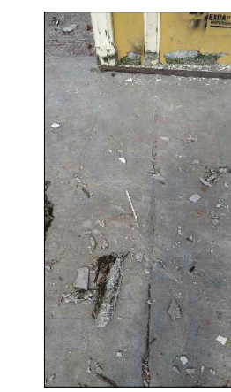
12 RACHADURA NO PISO.
