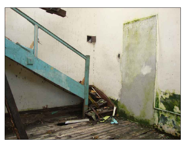
72 PISO E ESCADA DANIFICADOS.
