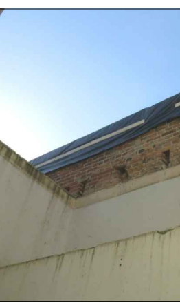
28 FORRO E COBERTURA INEXISTENTES.
