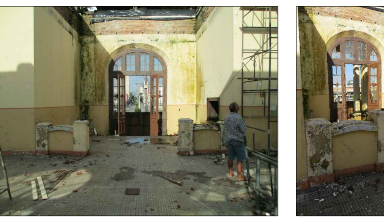
49 MURETAS E PAREDES DESCASCANDO E COM MANCHAS, ESQUADRIAS COM VIDROS QUEBRADOS.
