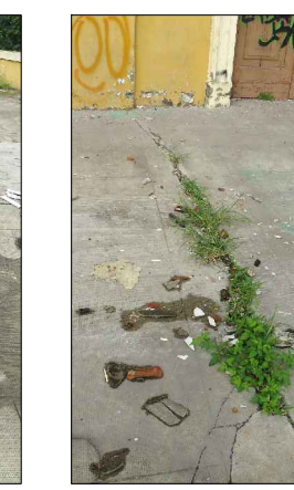
18 RACHADURA NO PISO.
