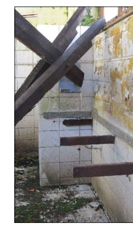
03 PIA DESCARACTERIZADA, COM PERDA DE MATERIAL.
