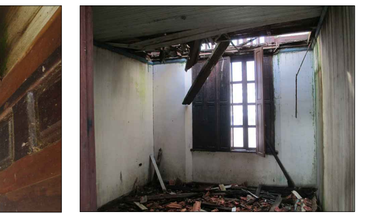
56 MANCHAS NA PAREDE E FORRO DANIFICADO.
