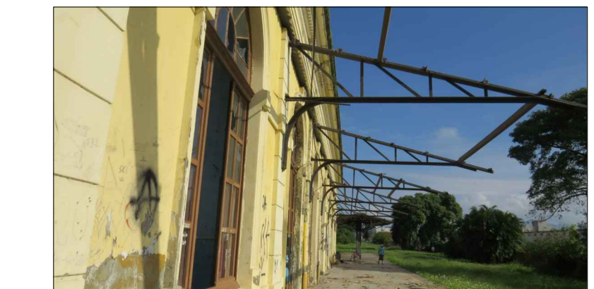
66 PERDA DA COBERTURA.
