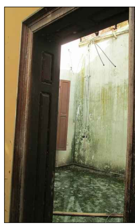
35 MANCHAS NAS PAREDES E PISO.
