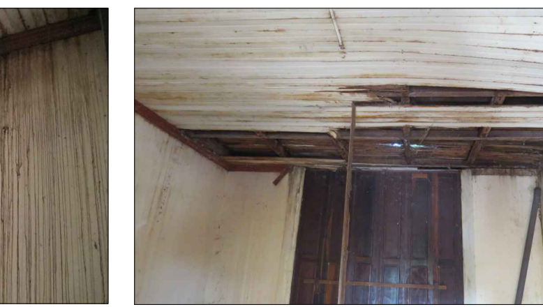
54 FALTA DA COBERTURA, UMIDADE NAS PAREDES, PISO DESGASTADO, FALTANDO PARTES DOS ORNAMENTOS DE COBERTURA, ESQUADRIAS EM MAU ESTADO.
