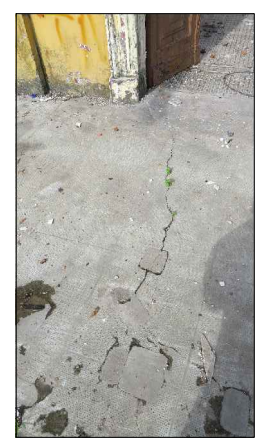
15 RACHADURA NO PISO.
