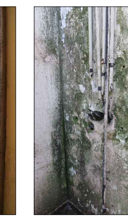
36 MANCHAS NAS PAREDES E PISO.
