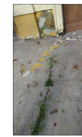
13 RACHADURA NO PISO.
