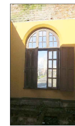
41 ESQUADRIA COM VIDROS E MADEIRA QUEBRADOS.
