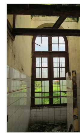
26 FORRO E COBERTURA INEXISTENTES.
