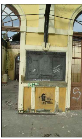
16 RACHADURA NO PISO.
