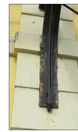
14 CORROÇÃO NA ESTRUTURA DA COBERTURA.
