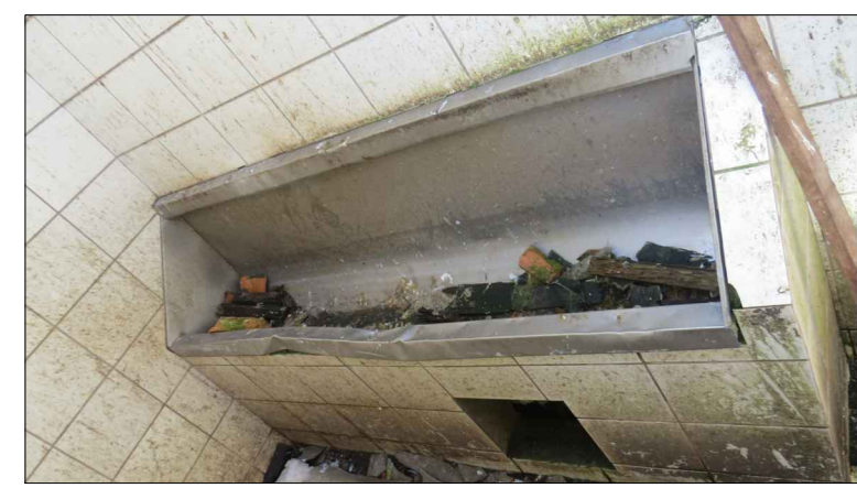
01 INSTALAÇÕES SANITÁRIAS DESCARACTERIZADAS E DANIFICADAS E/OU COM PERDA DE ELEMENTOS.
