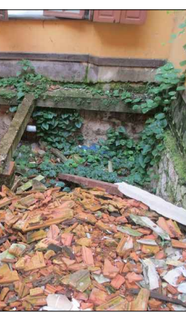
40 PISO COMPLETAMENTE PERDIDO.
