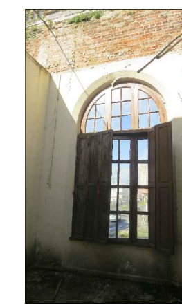
38 ESQUADRIA COM VIDROS E MADEIRA QUEBRADOS.
