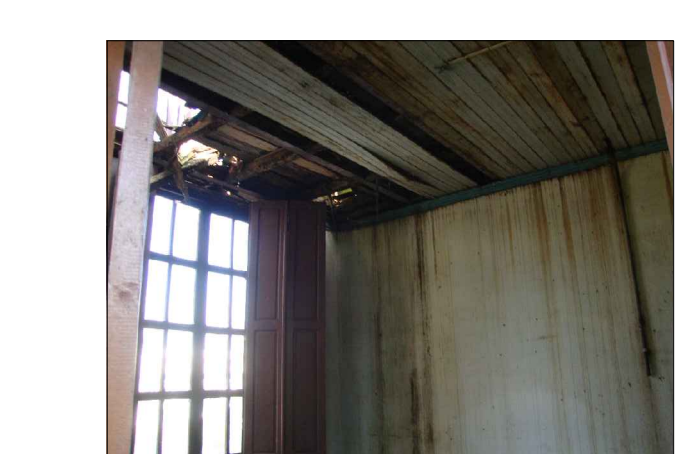
73 MANCHAS NA PAREDE E FORRO DANIFICADO.
