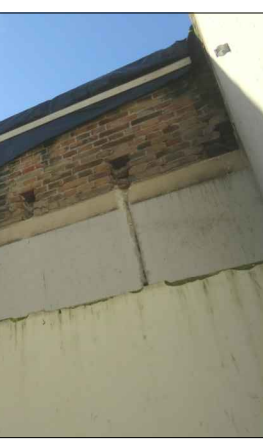
29 FORRO E COBERTURA INEXISTENTES.
