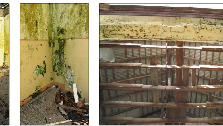
50 MANCHAS E LIMO NAS PAREDES.
