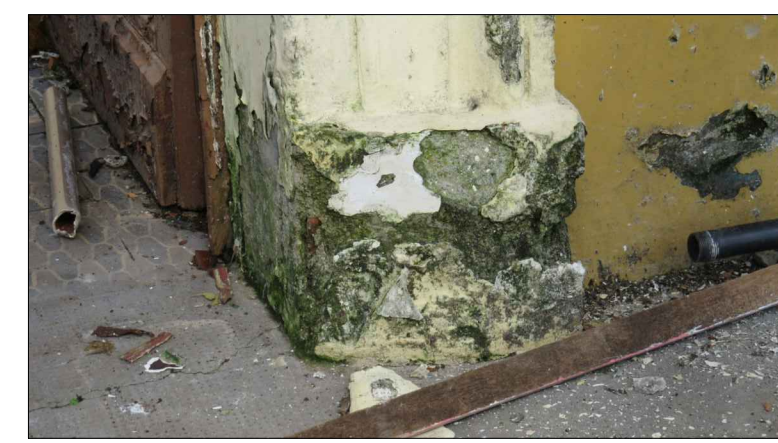
06 INFILTRAÇÃO, UMIDADE E LIMO NOS ELEMENTOS DAS PAREDES.
