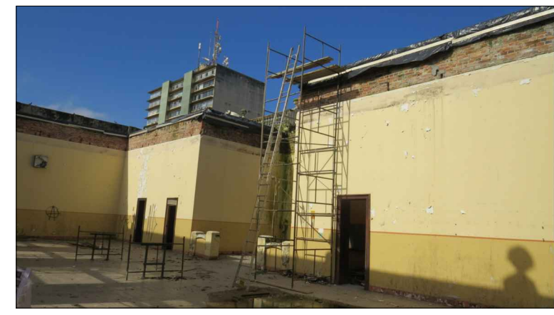
30 FORRO E COBERTURA INEXISTENTES.
