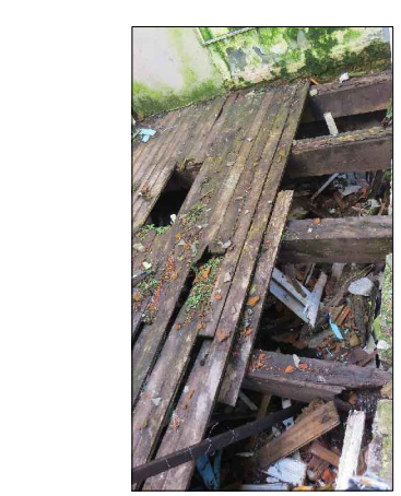
70 PISO PERDIDO E LIMO NAS PAREDES.
