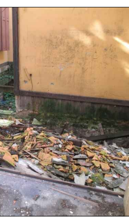
45 GUICHÊ COM MADEIRA DETERIORADA E SOLTANDO DA PAREDE.
