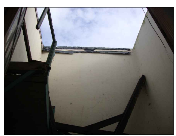
71 FORRO E TELHADO PERDIDO.
