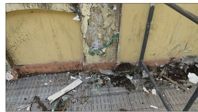
47 MURETA DESCASCANDO E PISO HIDRÁULICO COM MARCAS.
