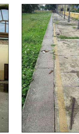
17 RACHADURA NO PISO.
