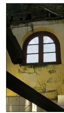
02 JANELA MODIFICADA E FORRO INEXISTENTE.
