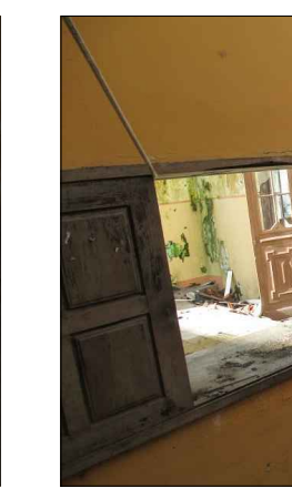
46 GUICHÊ COM MADEIRA DETERIORADA E SOLTANDO DA PAREDE.
