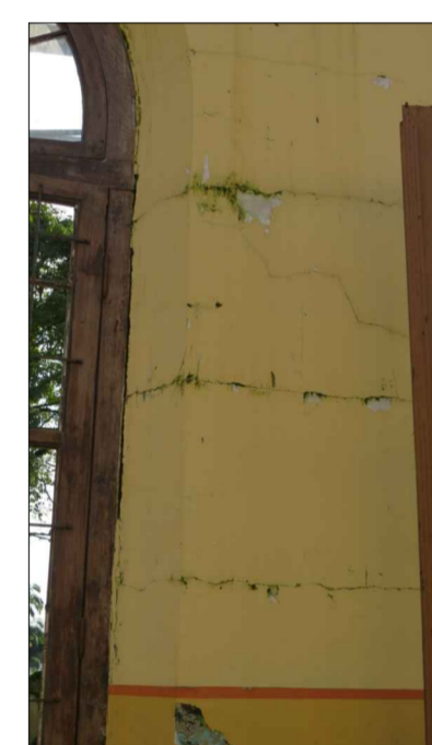
06 PAREDE DESCASCANDO E COM FISSURAS.
