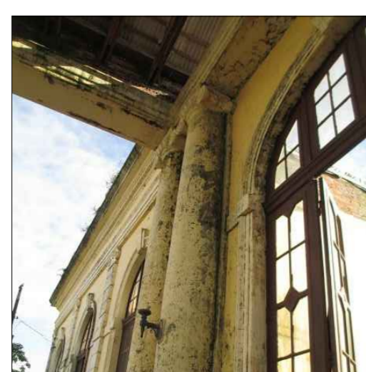
13 PINTURA DESCASCANDO E COM MANCHAS NA FACHADA E NOS ORNAMENTOS.
