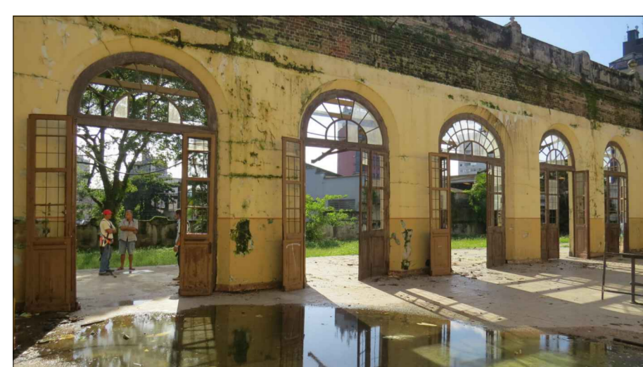
09 FACHADA INTERNA COM LIMO, FISSURAS E COM TINTA DESCASCANDO.
