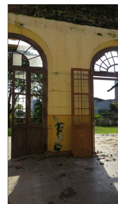
04 PAREDE COM FISSURAS E DESCASCANDO.
