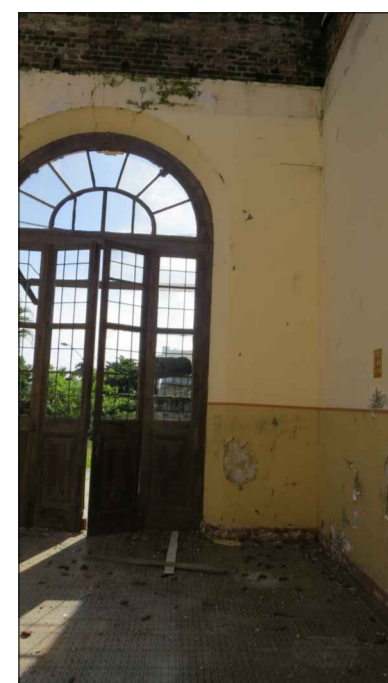
01 PAREDE COM FISSURAS E DESCASCANDO.
