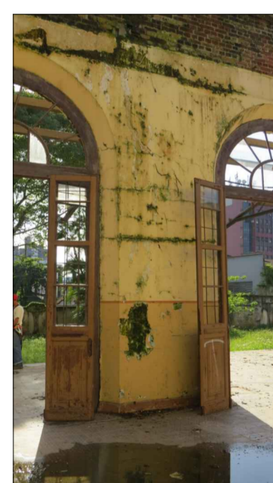
07 PAREDE COM FISSURAS E DESCASCANDO.
