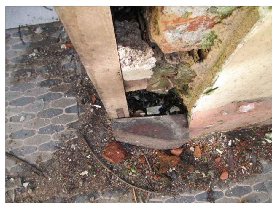
16 FALTA DO CAIXILHO, PAREDE E RODAPÊ DANIFICADOS.
