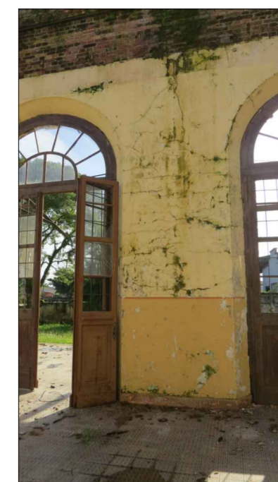
02 PAREDE COM FISSURAS E DESCASCANDO.
