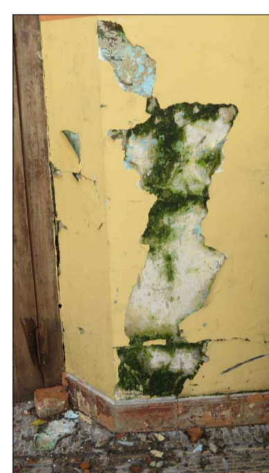
05 PAREDE DESCASCANDO E COM LIMO, RODAPÊ DANIFICADO.
