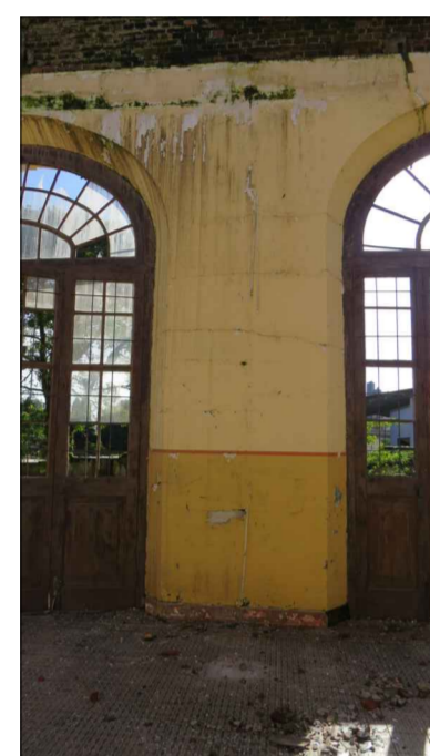
03 PAREDE COM FISSURAS E DESCASCANDO.
