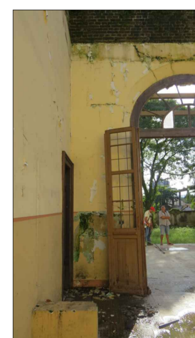
08 PAREDE COM FISSURAS E DESCASCANDO.
