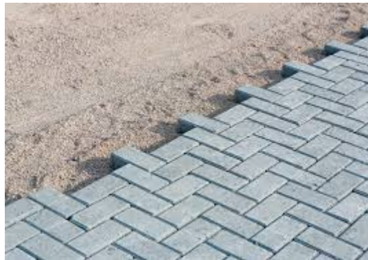
FIGURA 5 - IMAGEM DO BLOCO DE CONCRETO INTERTRAVADO
