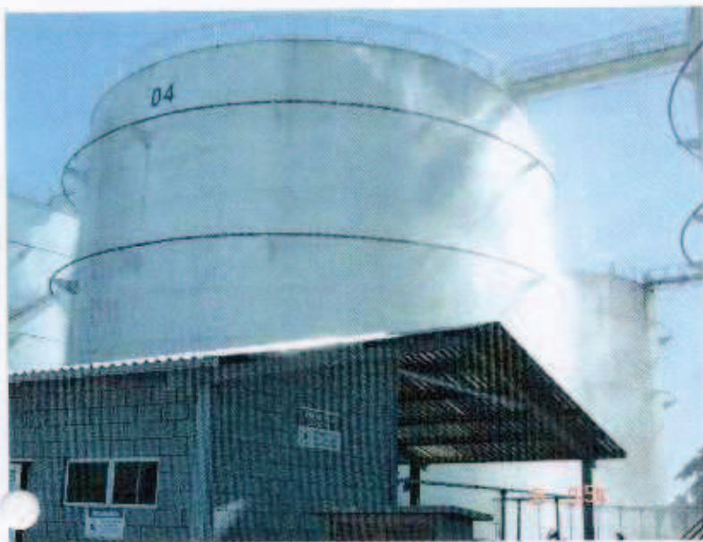
Resfriamento dos tanques com sistema de aspersão.
