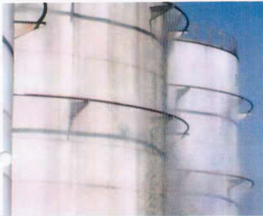
Funcionamento do Sistema de Resfriamento dos tanques por aspersores.
