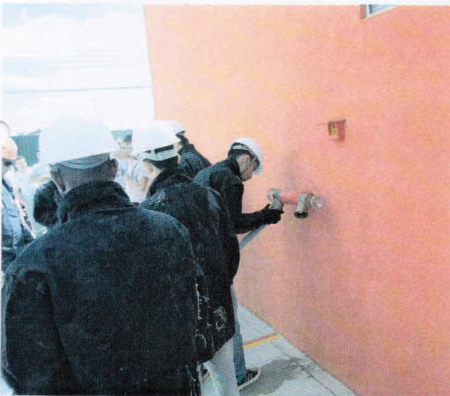
Acoplamento no hidrante.
