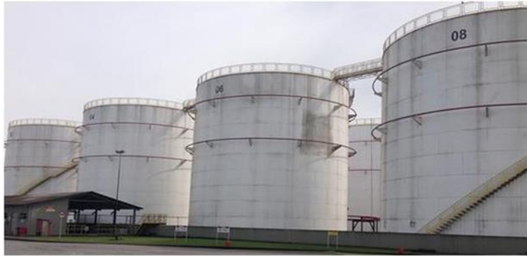
Figura 7 – Tanques de armazenagem do Terminal de Álcool CPA
