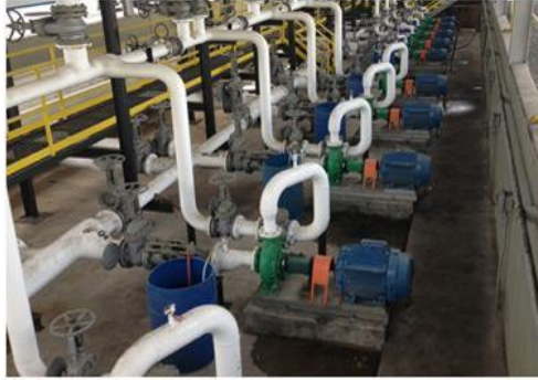
Figura 5 – Casa de bombas rodoferroviária, responsável pela transferência dos produtos que chegam ao terminal aos tanques de armazenamento.
