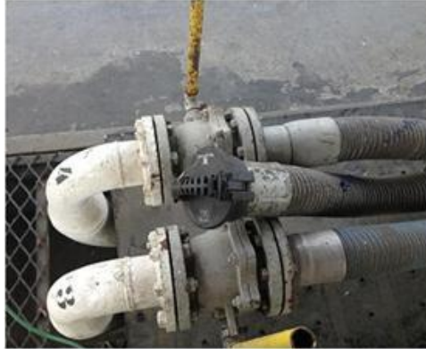
Figura 3 – Safety bumps vedando extremidade do mangote de descarga de caminhões tanque
