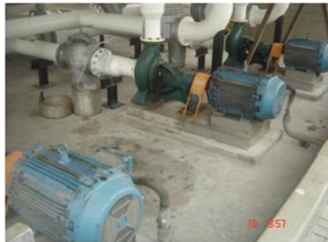
Figura 6 – Casa de bombas de exportação, responsável pelo bombeamento de produtos dos tanques para navios.
