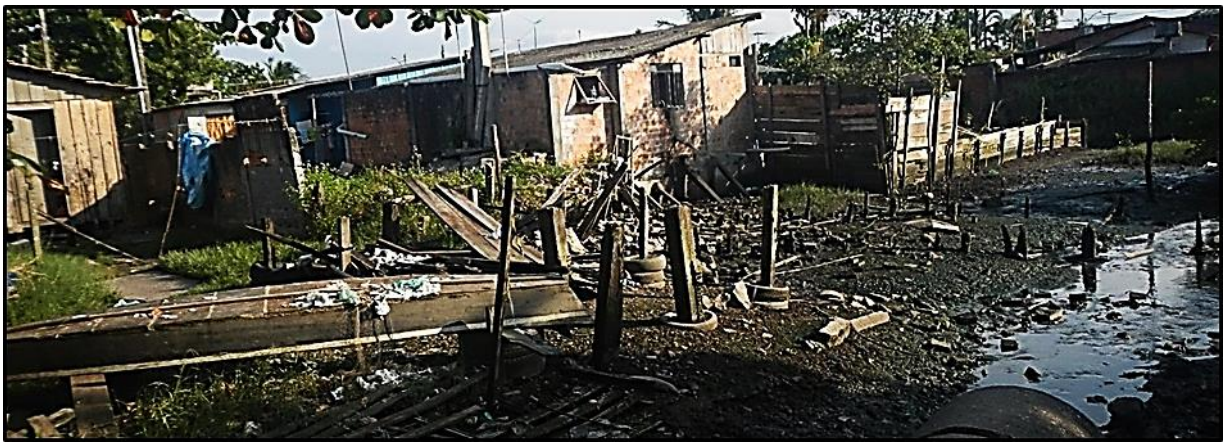
Figura 113 - Casas próximas à margem da baía – unidade de paisagem Ocupações de área de mangue.
