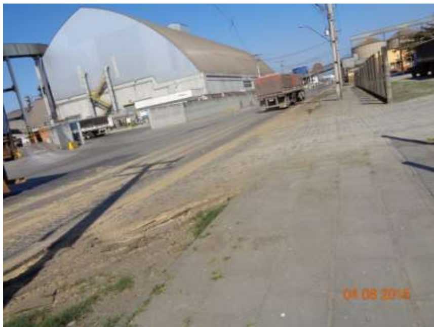
Figura 8: Deficiências no calçamento que auxiliam no acúmulo de água e de grãos.
