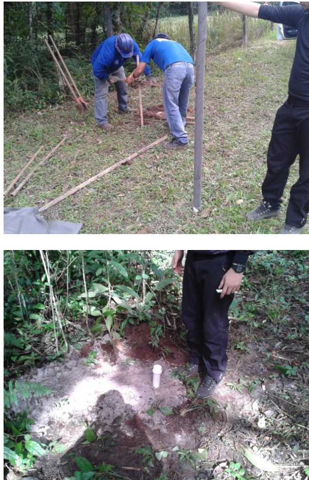
Figura 4-19 - Procedimento de instalação do poço piezômetro: a) Perfuração para instalação de poço piezômetro, utilizando trado helicoidal. Em primeiro plano aparece a coluna de revestimento com o filtro envolvido por manta de bedin, aguardando para ser instalada na perfuração; b) Poço piezômetro já instalado e em operação.
