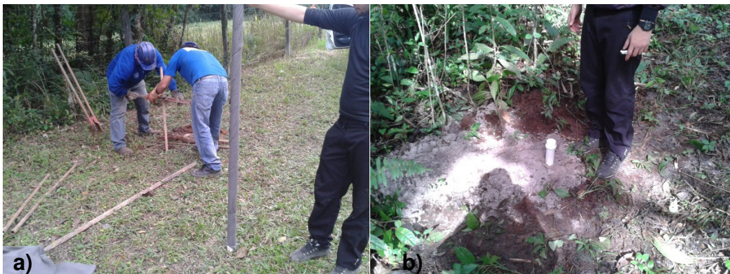
Figura 3-6 - Procedimento de instalação do poço piezômetro: a) Perfuração para instalação de poço piezômetro, utilizando trado helicoidal. Em primeiro plano aparece a coluna de revestimento com o filtro envolvido por manta de bedin, aguardando para ser instalada na perfuração; b) Poço piezômetro já instalado e em operação.
