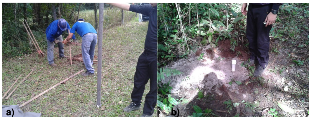
Figura 2-5 - Procedimento de instalação do poço piezômetro: a) Perfuração para instalação de poço piezômetro, utilizando trado helicoidal. Em primeiro plano aparece a coluna de revestimento com o filtro envolvido por manta de bedin, aguardando para ser instalada na perfuração; b) Poço piezômetro já instalado e em operação.
