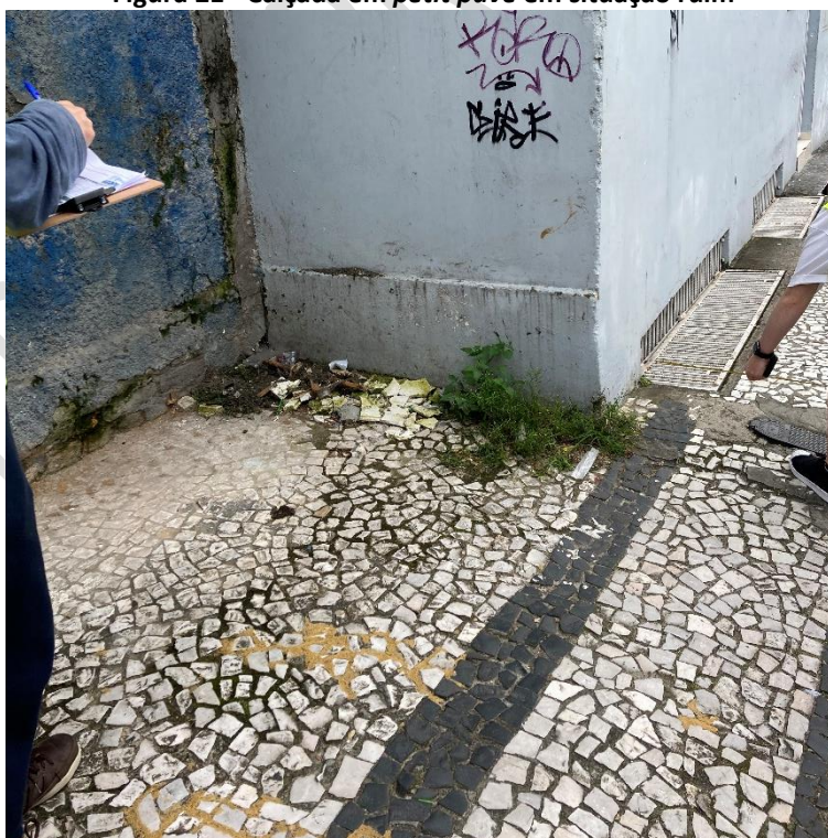
Figura 21 - Calçada em petit pavê em situação ruim
