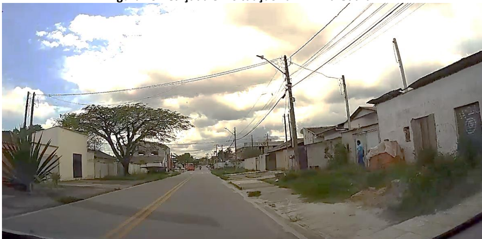
Figura 23 - Calçada em situação ruim - Vila Guarani
