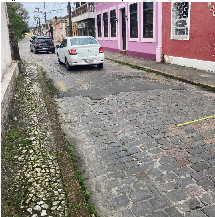
Figura 16 – R. Conselheiro Sinimbu – pavimento considerado ruim
