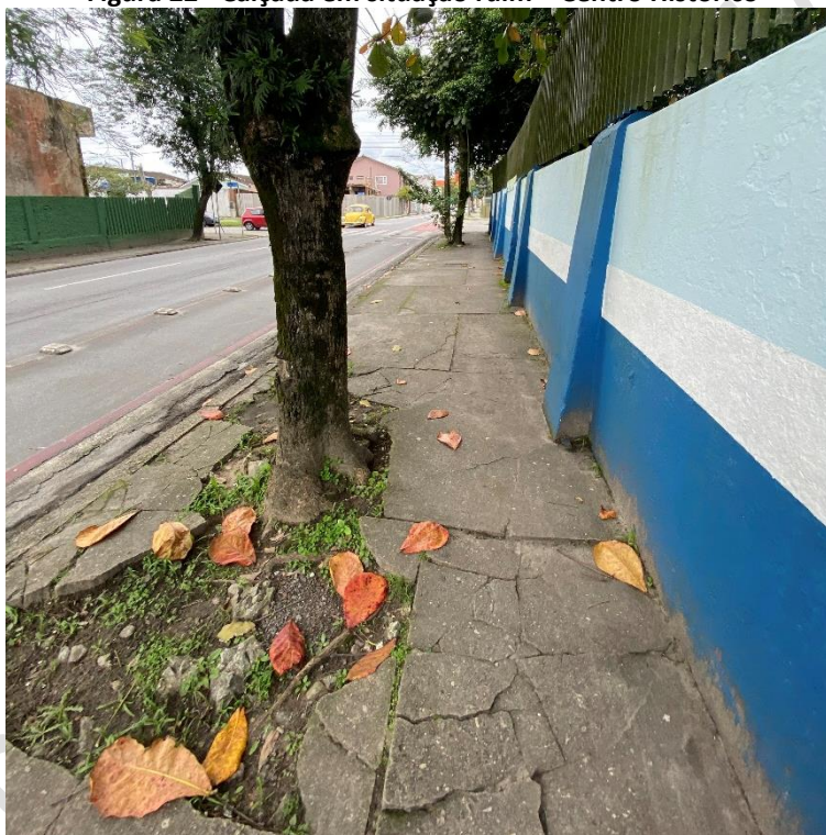
Figura 22 - Calçada em situação ruim – Centro Histórico
