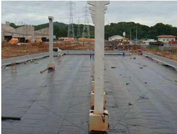
Implantação de pátio de estocagem de enxofre. Impermeabilização com PEAD – Polietileno de Alta Densidade (abr/2008).
