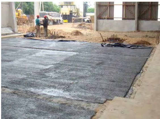
Implantação piso impermeabilizado na área dos armazéns de estocagem de fertilizantes (mai/2008).
