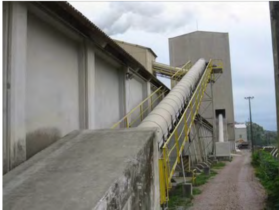
Armazenamento de rocha: esteiras cobertas
