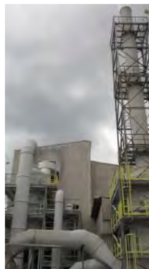
Lavadora de gases e chaminé
