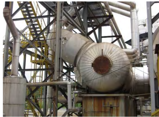
Caldeira de recuperação
