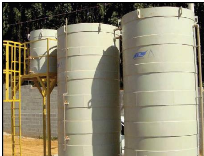
Figura 19- Exemplo de estação de tratamento de esgoto compacta que será utilizada no empreendimento.
